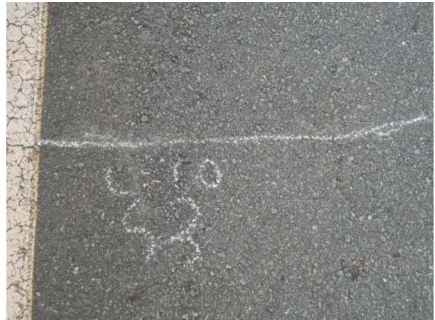
아스콘 포장 균열(S3)
