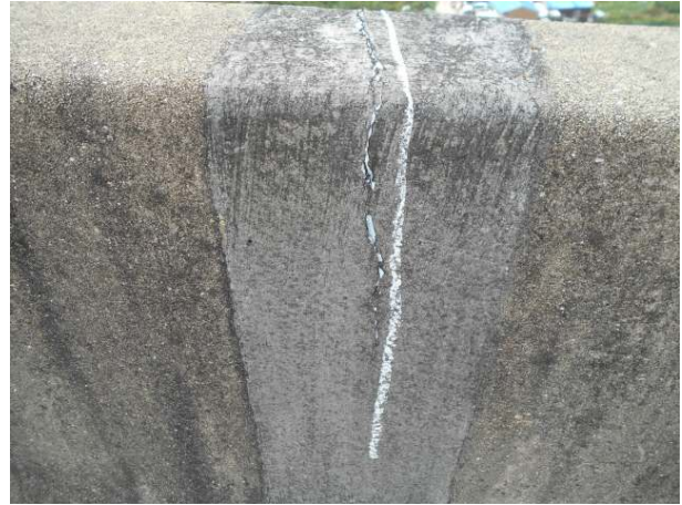
S4 방호벽 균열(0.3mm이상)
