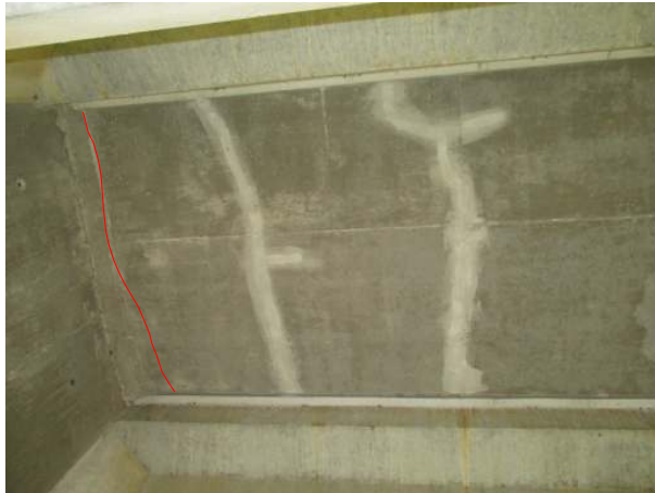
S4 바닥판 하면 균열 및 백태
