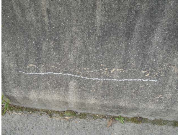
S1 방호벽 균열(0.3mm미만)
