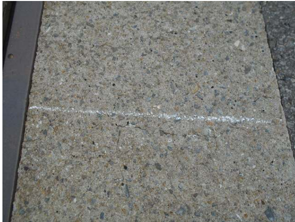
A1 후타재 균열(0.3mm이상)
