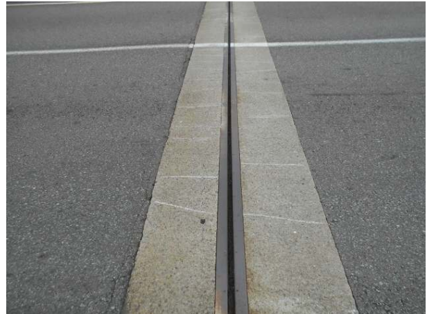
A2 후타재 균열(0.3mm미만)
