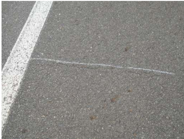
아스콘 포장 균열(S1)
